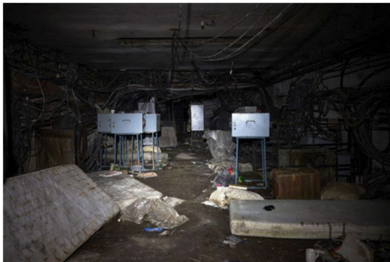
Au sous-sol, des matelas volés dans le voisinage maintenant à même le sol. © Eric Lucido
